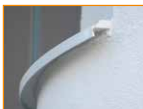
Goutte d'eau cintrée
