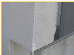
Isolant sur rail de départ
