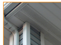
Angle et ventilation
